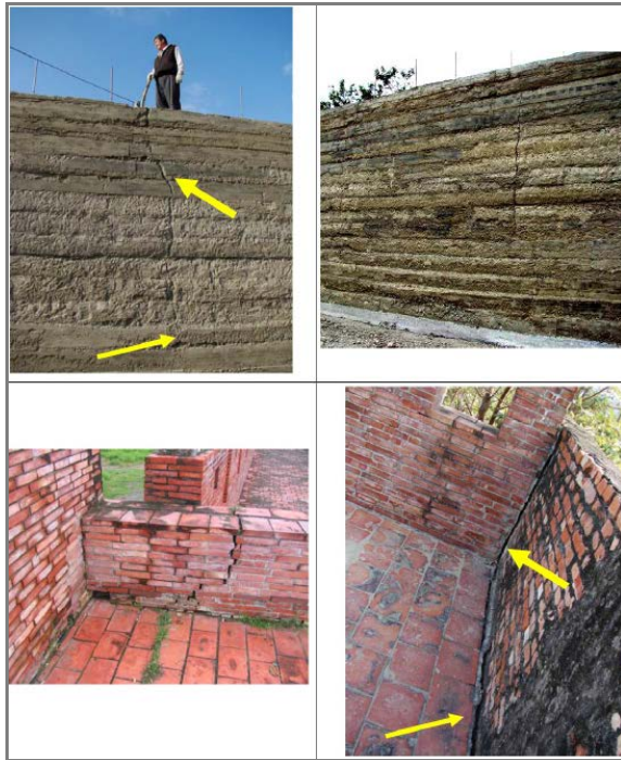
圖十 城牆震後出現之環形斷裂及外傾裂縫
