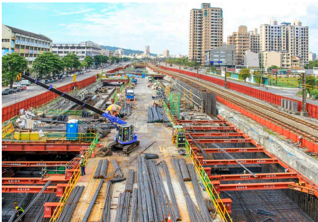
C6 高雄鐵路地下化明挖覆蓋工法華安街段2013年施工情況
