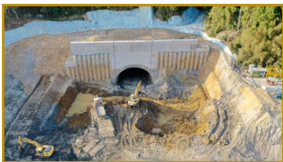
C1 隧道進水口開挖採用擋土排樁配合設置隧道頂蓋擋土牆，降挖後以管幕工法開挖入洞，縮減進水口與隧道施工界面
