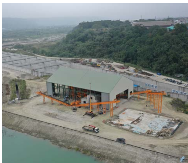
D3 篩分場將對淤泥進行分篩，讓大於0.1mm 細砂供作營建砂石再利用，小於0.1mm 淤泥堆置在沖淤池，待颱風洪石進行水力沖淤庫中游抽泥的排放管道
