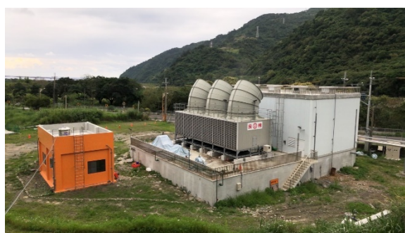
圖九 全陽地熱金崙電廠一景
