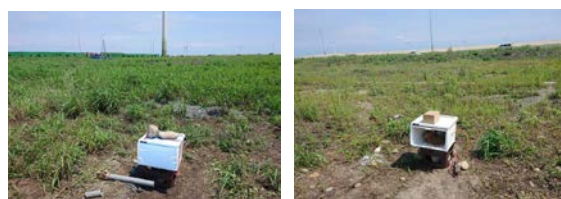
BH-4 VWdot NB-IoT記錄器 BH-6 VWdot NB-IoT記錄器
