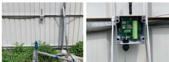
水位觀測井與 VWdot記錄器 VWdot NB-IoT記錄器
