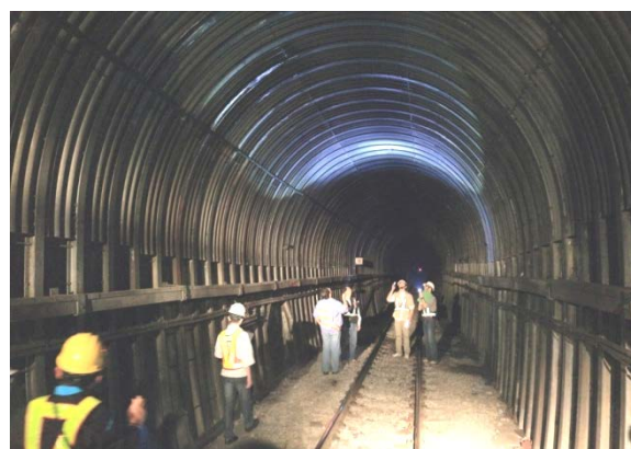
圖八 多良一號隧道鋼肋補強及淨空不足情形
