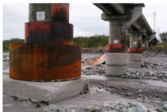
圖四 利嘉溪橋沉箱基礎裸露情形
