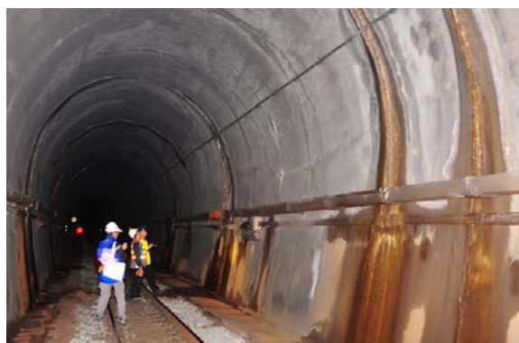
圖六 金崙隧道內滲漏水情形
