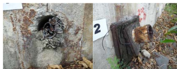
(a) 錨頭掉落
