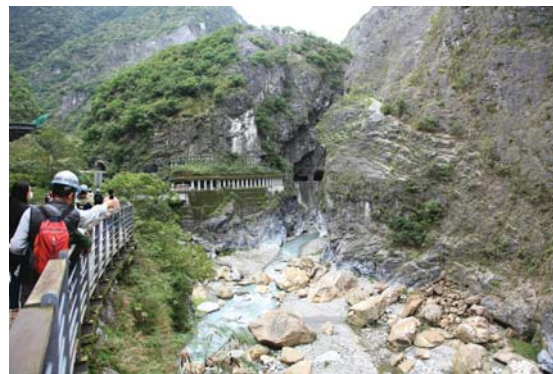
圖三 燕子口步道旁落石防護工法(詹佩臻攝)
