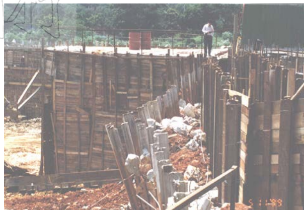
照片二 桃園楊梅案例鋼軌樁傾倒破壞
