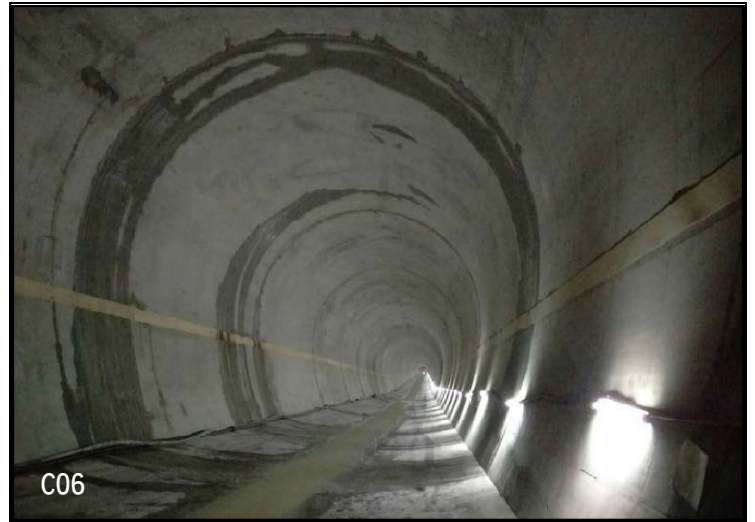
C06 防淤隧道一般段為內徑約 9 公尺之三心圓隧道，照片為襯砌結構完成之狀況，塗佈耐磨層材料後可防止高速水流沖刷
