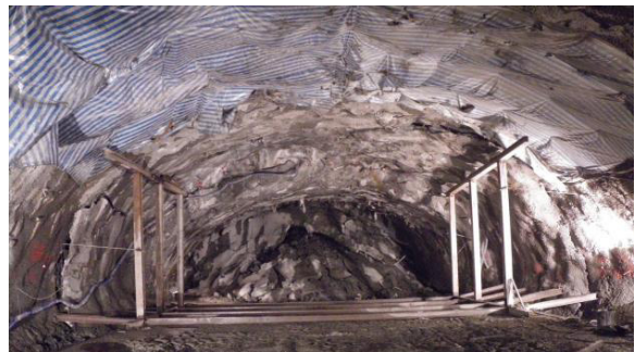
圖十四 沉泥層隧道頂拱大量變形緊急處理
