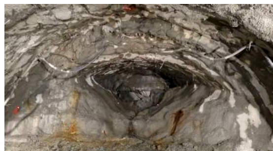
圖四 沉泥層隧道頂拱大量變形
