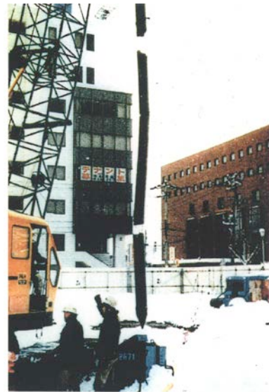
照片二 拔出後受害樁之狀況
