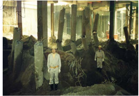
照片一 樁之受害狀況
