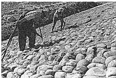
照片六 大安溪乾砌卵石堤防縫噴漿（約民國 54 年）
