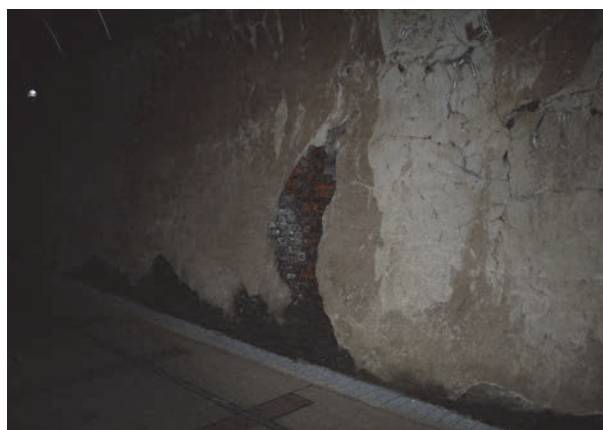
(d) 噴凝土剝落
