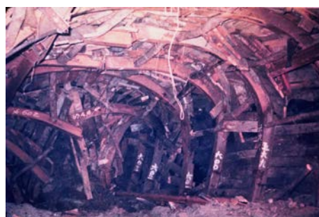
投影片3 底導坑鋼支保因沈泥擠壓坍塌40m
