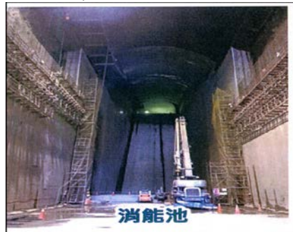
投影片 17 曾文水庫防淤隧道消能池室襯砌(摘自水利署南水局簡報)
